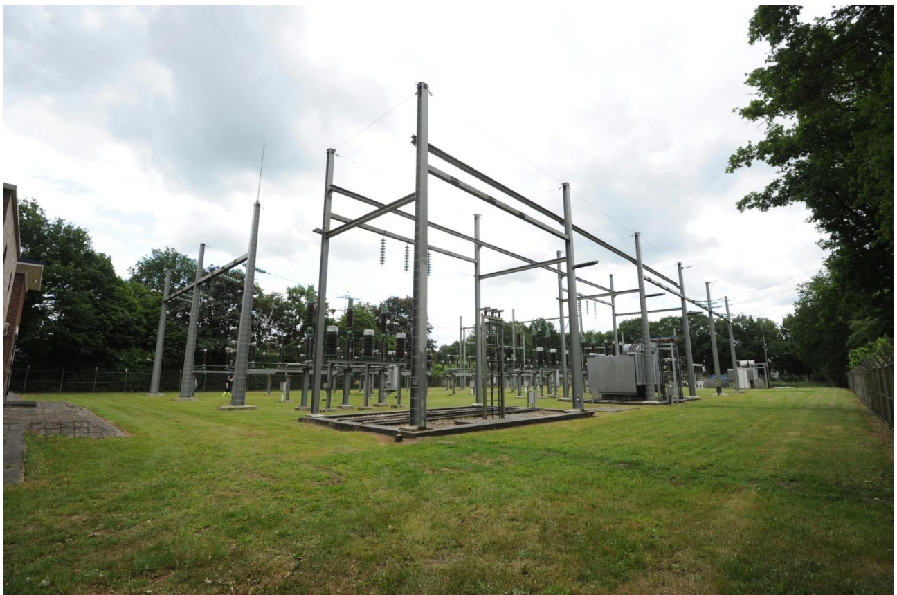
Figuur 1: Foto van bestaand hoogspanningsstation Raalte 110 kV
